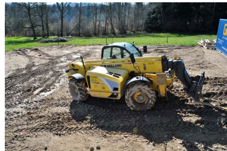
Photographie 33 : Exemple de tassement et d'ornières créés par les engins de chantier
